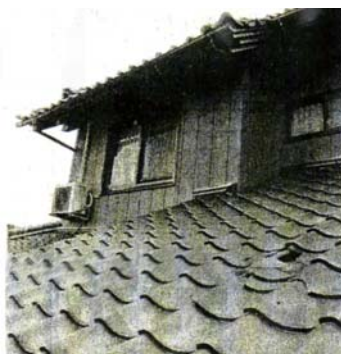
屋根ガワラが壊された住宅
