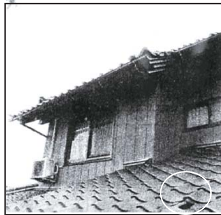
6月6日の落下物事故で破損した屋根（〇印成田市西大須賀）
